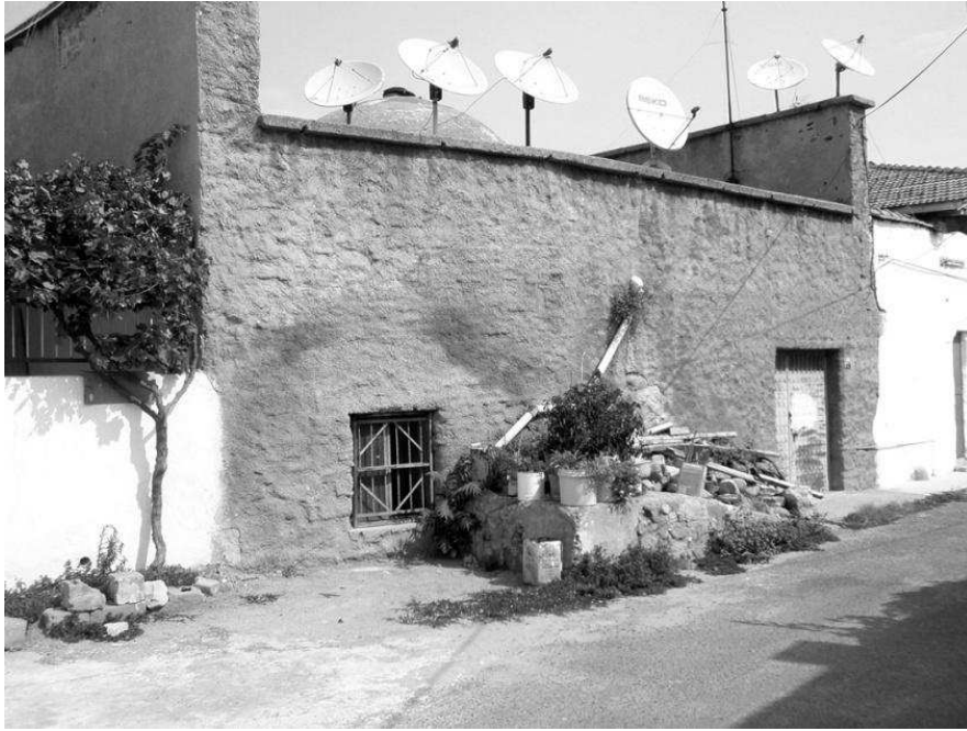
Kilise Hamamı'nın Eski Gazhane Sokak'tan görünümü 11 (resimde yıkılıp açılı bir biçimde yeniden inşa edilen cephe ve sonradan açılan pencere ile kapı da görülmektedir)
